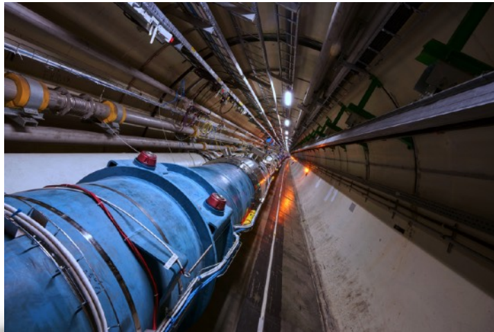
(Figura 1.6) L'interno del tunnel di LHC dove sono stati installati i magneti superconduttori
